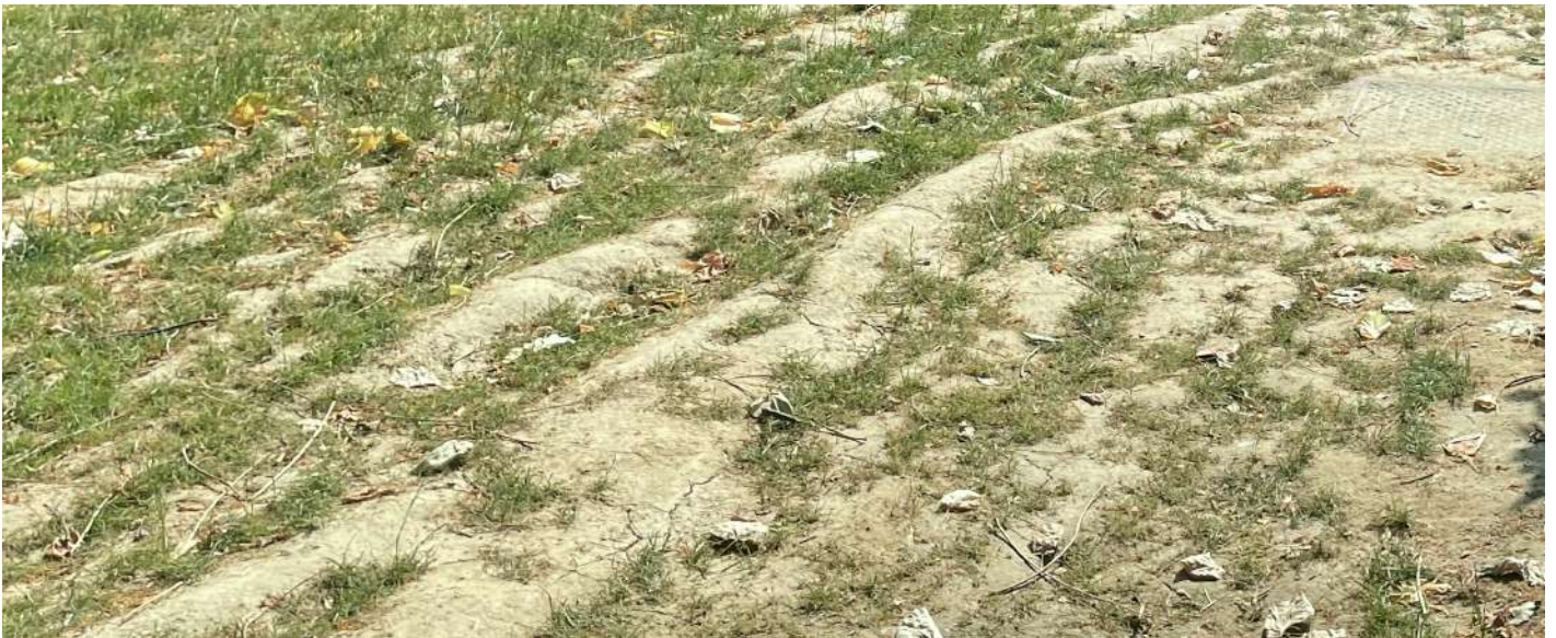
Danni da passaggio di mezzi meccanici in condizioni di terreno argilloso bagnato
